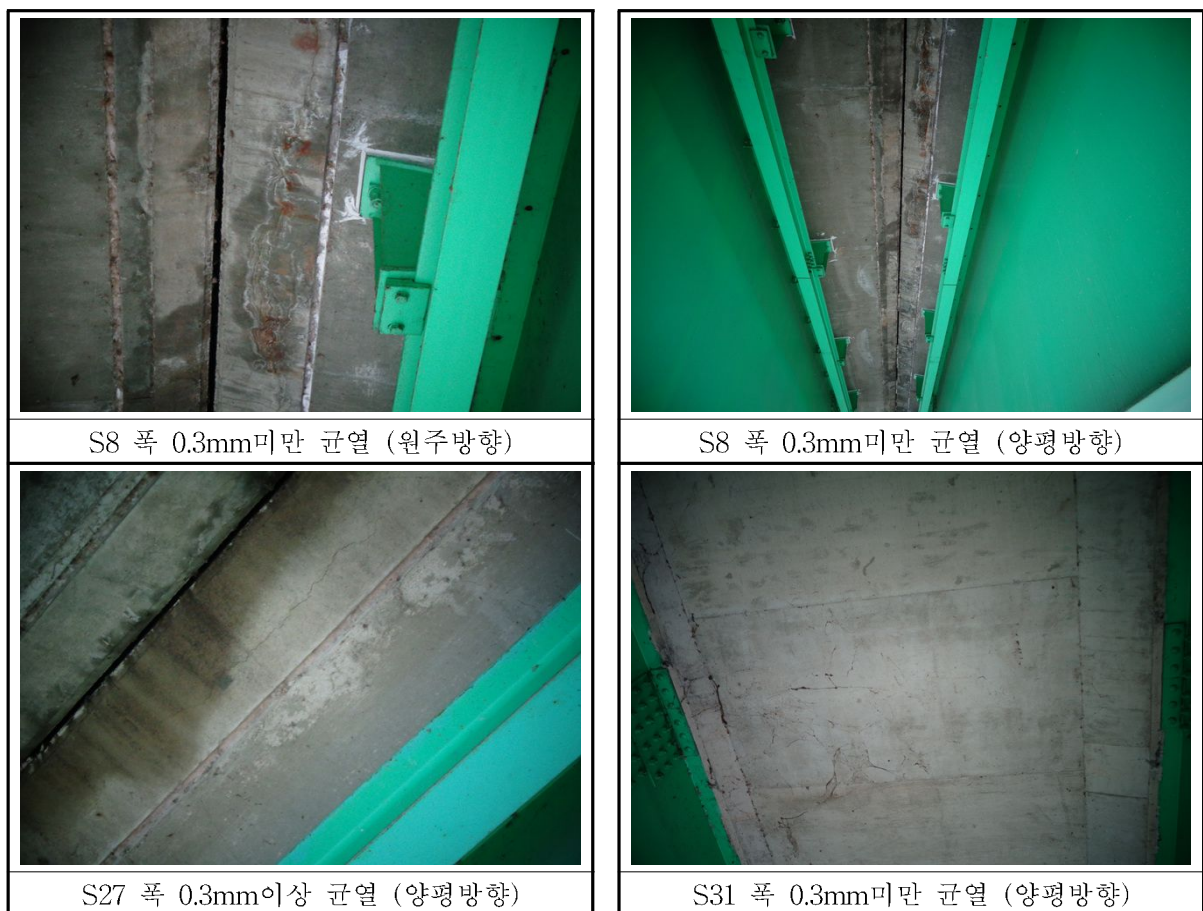
【그림 7.4】 바닥판하면 손상현황
