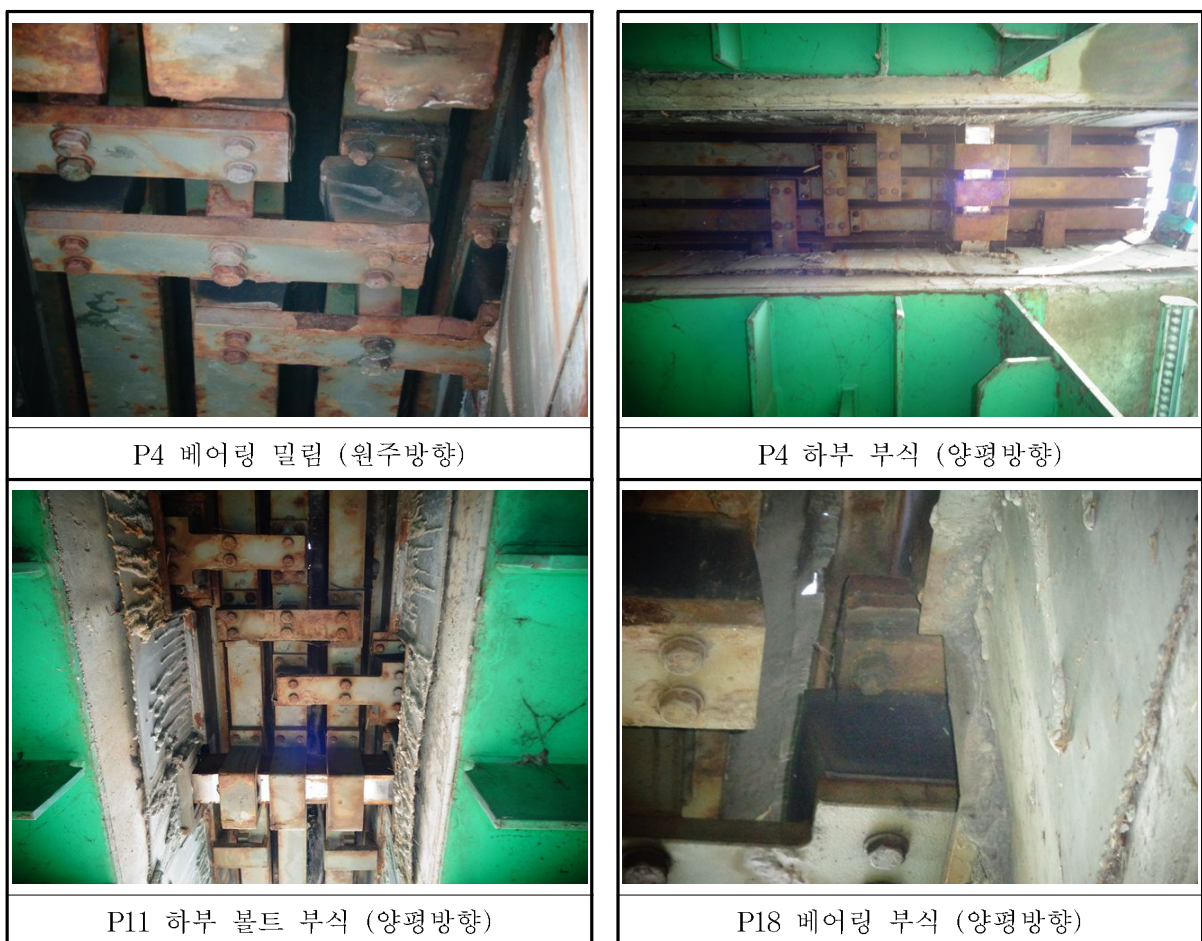
【그림 7.3】 신축이음 손상현황
